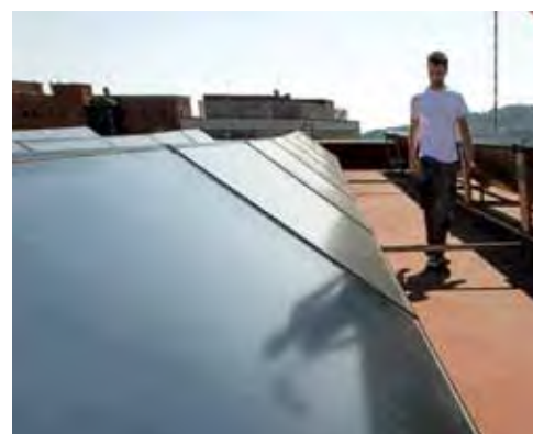
Instal·lació d'Aiguasol Enginyeria.
