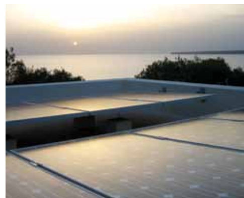
Instal·lació de la cooperativa Azimut 360.
